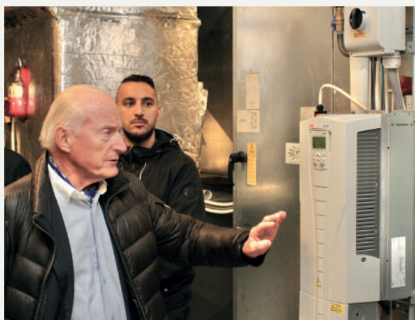
Her ser vi Christian Ringnes på jakt etter energytver i Thorvald Meyers gate 2, Oslo. Bildet er fra teknisk rom hvor ventilasjonsanlegg besiktiges. Foto: Glen Widing, Estate Nyheter.
